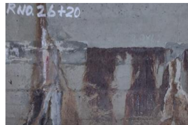
損傷箇所や漏水箇所
