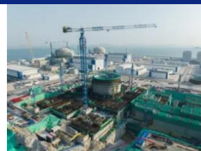
原子力発電所
