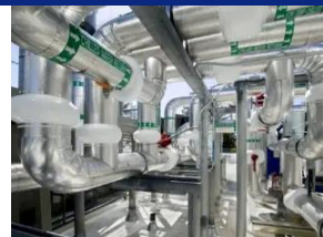
ダクト配管内部
