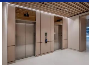
エレベーター
