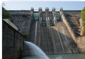
人が近づけない設備の点検
